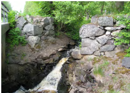
● ● ● Figur 41 Fall vid damm precis uppströms väg 575 före åtgärd
