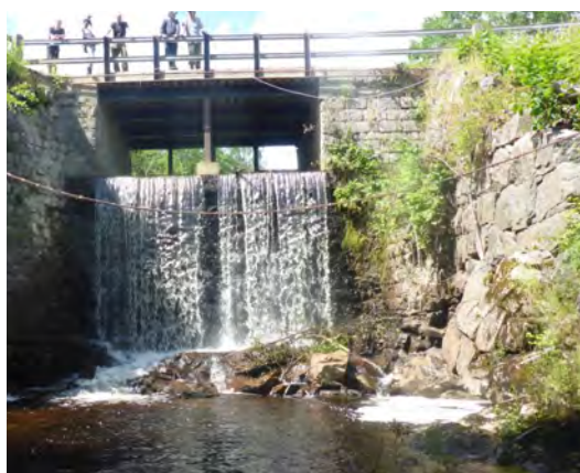
● ● ● Figur 8 Branddammen innan åtgärd
